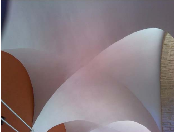
Figura 29a. Información visible de la presencia de humedades debidas a un conducto empotrado en el muro.
