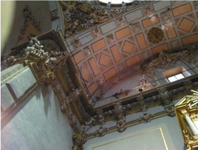
Figura 27a. Información visible de filtraciones de agua de lluvia en la Iglesia de Nuestra Señora De los Ángeles en Chelva.
