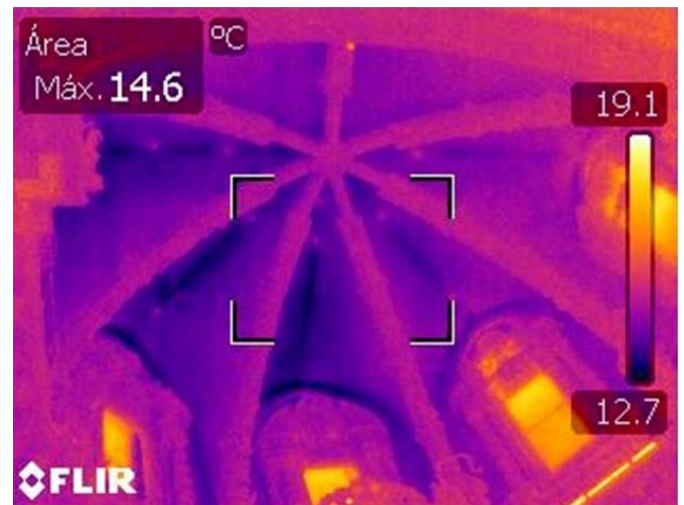
Figura 28b. Información térmica de condensaciones superficiales en el Presbiterio Catedral de Valencia.
